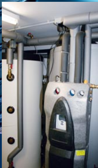
Zwei 800-Liter-Pufferspeicher sorgen für Wärmekomfort nach Maß.
