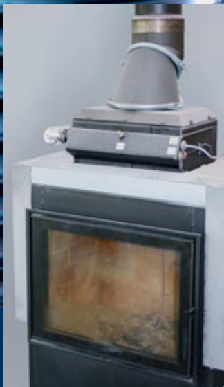
Der Kaminofen speist seine Wärme direkt in den Solar-Pufferspeicher ein.
