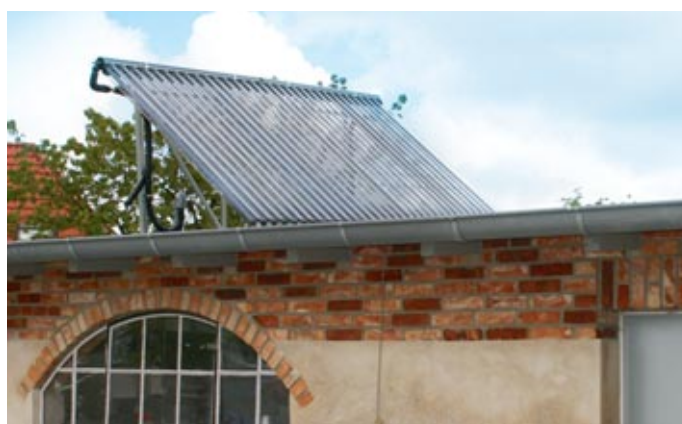
Die Gratis-Wärme aus der Röhrenkollektor-Solarthermie-Anlage wird zur Warmwasserbereitung und Heizungsunterstützung genutzt.
