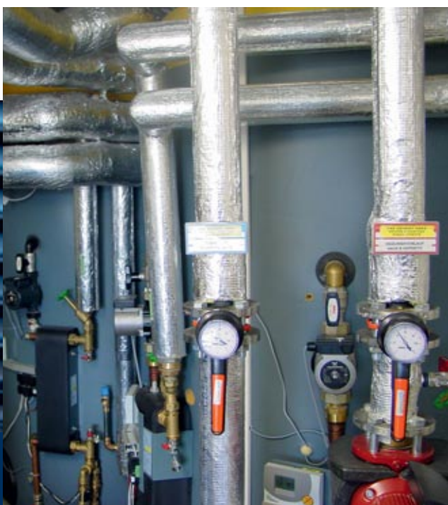
Zwei 1.500-Liter-Pufferspeicher und Hocheffizienzpumpen sorgen für Wärme komfort nach Maß.
