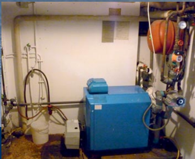
Die alte Ölheizungsanlage stammte aus dem Jahr 2001.
