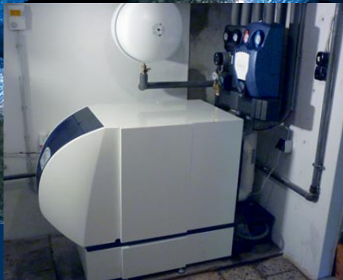
Hocheffizienz im Heizungskeller: Die fertig installierte EcoStar Hybrid
