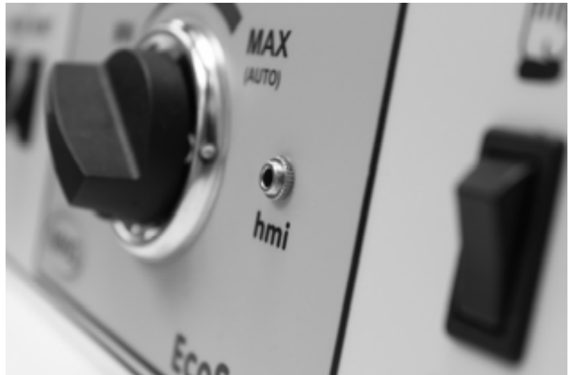
Abb. 9: hmi-Anschlussbuchse des Kesselschaltfeldes
