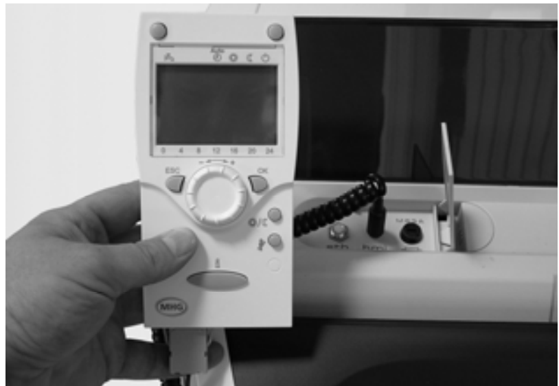
Abb. 8: Verbindung der Bedieneinheit QAA 75 mit dem Kesselschaltfeld
